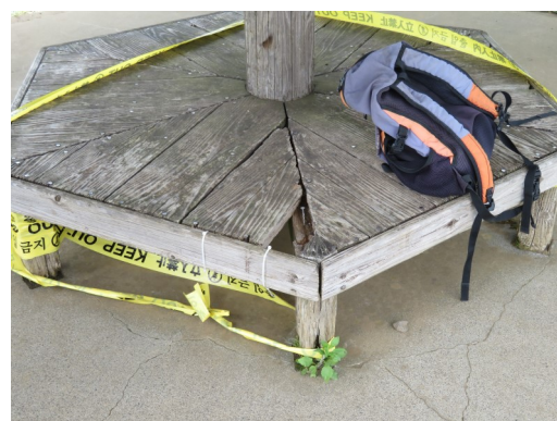
老朽化により、座面の破損、ガタつきがみられるあずま屋の縁台部分(大平山山頂)
