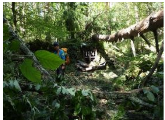
10月2日(火) 倒木により吉田胎内神社の祠が倒壊していた
